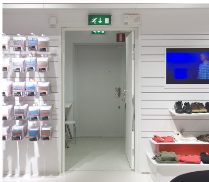
Trädörr i butik och utanför den en larmad och utrymningsutrustad säkerhetsdörr
